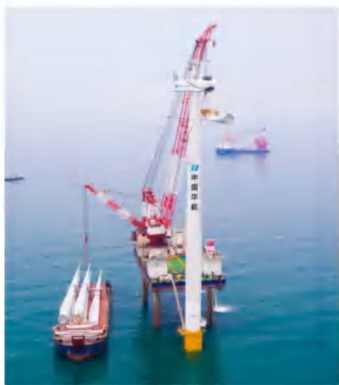
海南华能临高CZ1海塔 MYSE10-242 10MW
