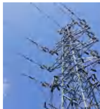
架空集电线路故障诊断
