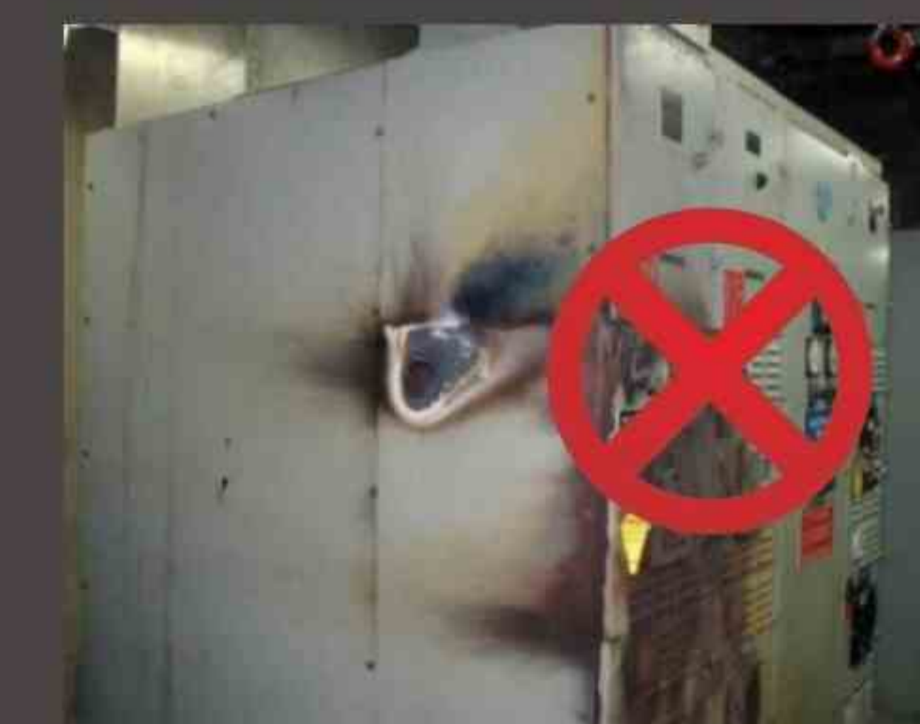
烧坏的电气柜
